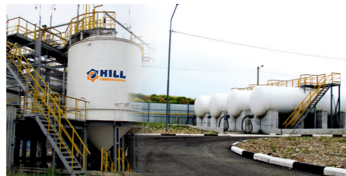
Крупный резервуарный парк для хранения базовых и товарных масел
