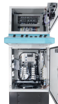
Шкаф управления, изготовленный после консультаций с операторами и конструкторами
